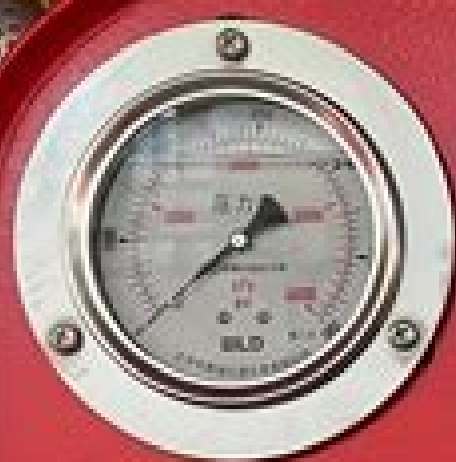
蓄能器压力 ACCUMULATOR PRESSURE
