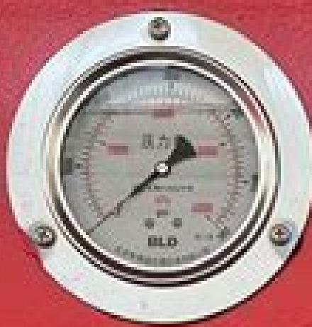
管汇压力 MANIFOLD PRESSURE
